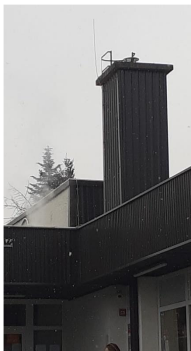
Slika 2. Dimnjak samostojećeg kotla Viessmann Vitogas 100
