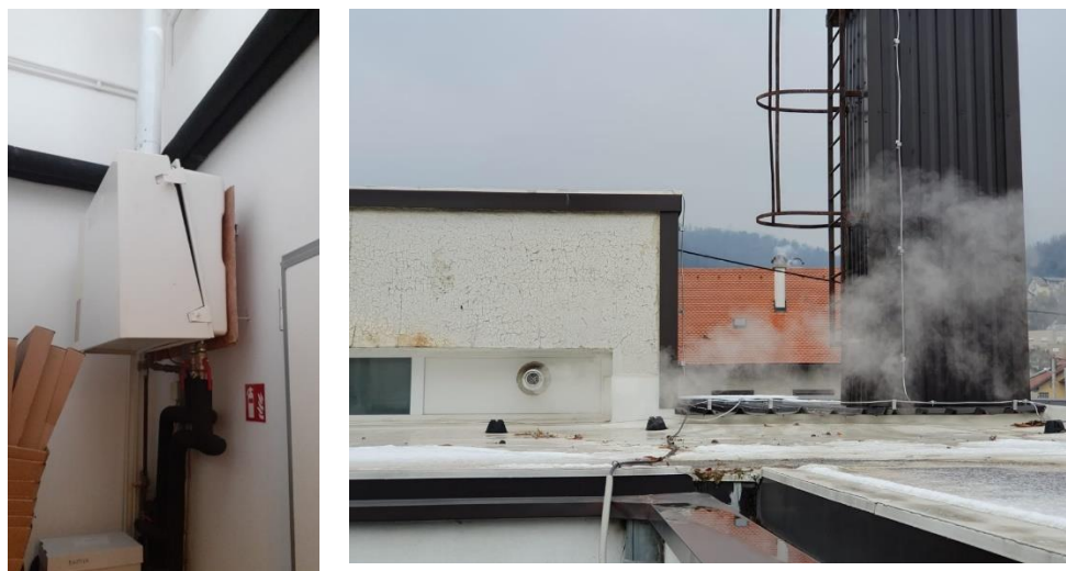
Slika 3. lijevo - plinski bojler Logamax plus GB 112-43, ugrađen u prizemlju objekta; desno - dimnjak bojlera Logamax plus GB 112-43
