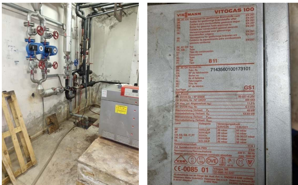
Slika 1. Samostojeći kotao Viessmann Vitogas 100 ugrađen u podrumu objekta, u strojarnici
